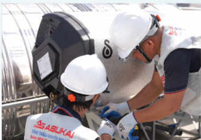
Dự Án Nước Nóng Tại Khu Tổ Hợp Nghỉ Dưỡng Và Khách Sạn 5 Sao Maris Vũng Tàu
